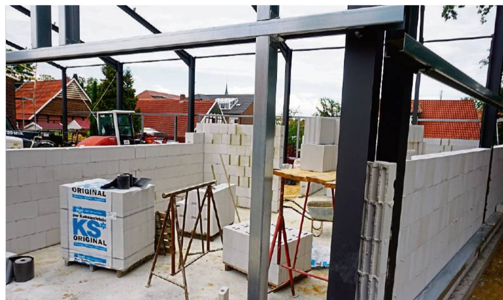
Die Arbeiten für den Bau einer neuen Werkhalle für das Autohaus Ricker in Berge sind im vollen Gang. Im März 2019 soll alles fertig sein.
